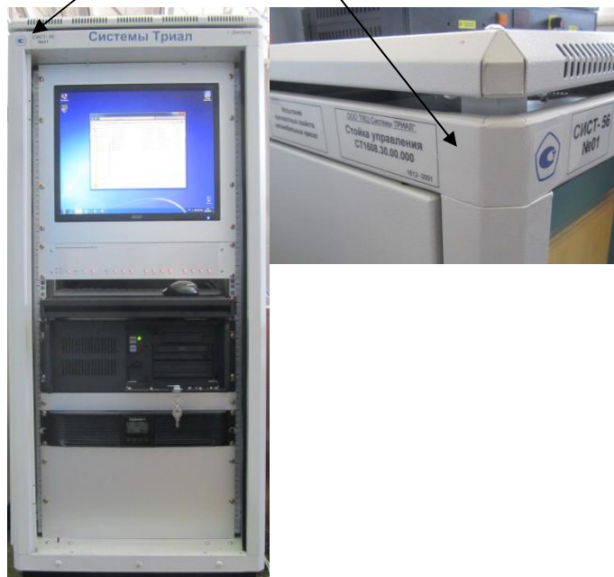
Рисунок 1 - Общий вид стойки управления
