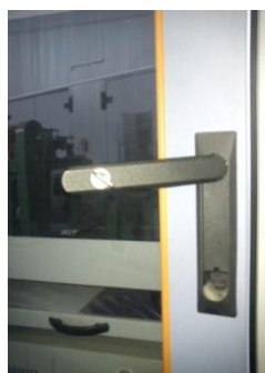
Рисунок 6 - Внешний вид замка на дверце стойки управления
