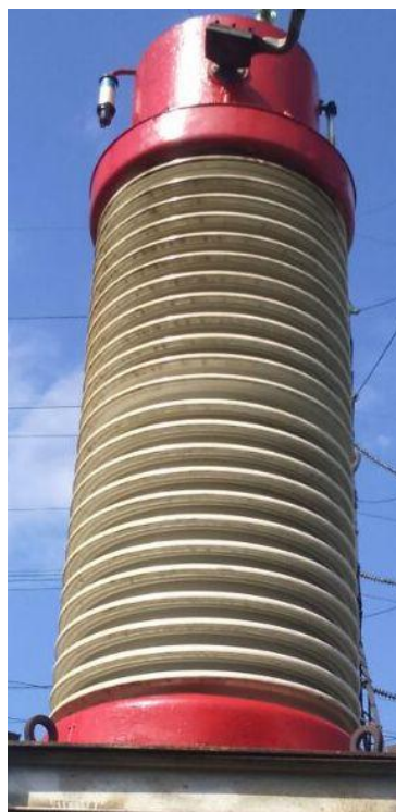
Рисунок 1 - Общий вид трансформаторов тока
