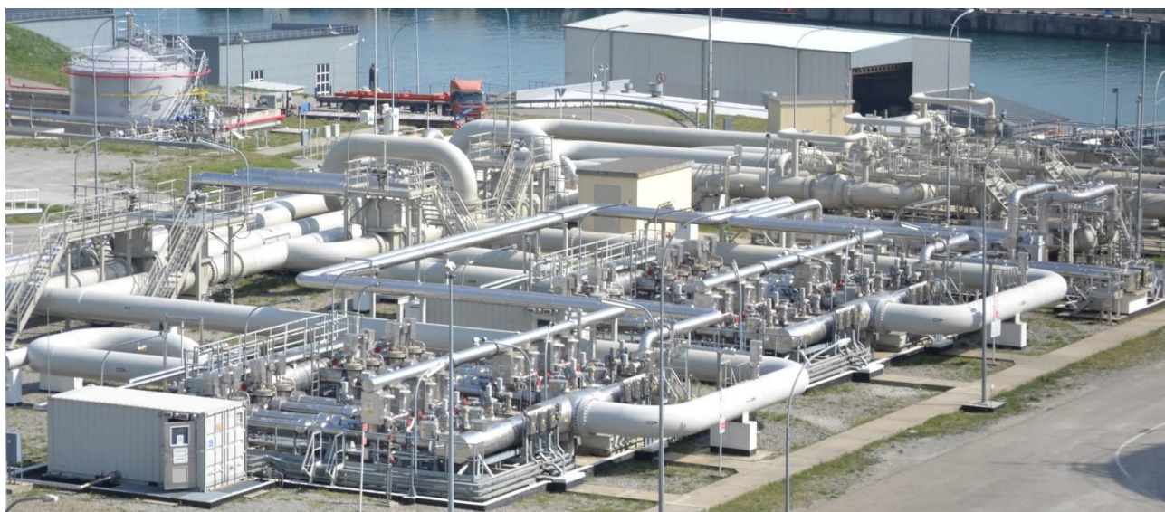
Рисунок 1 - Общий вид СИКН.
