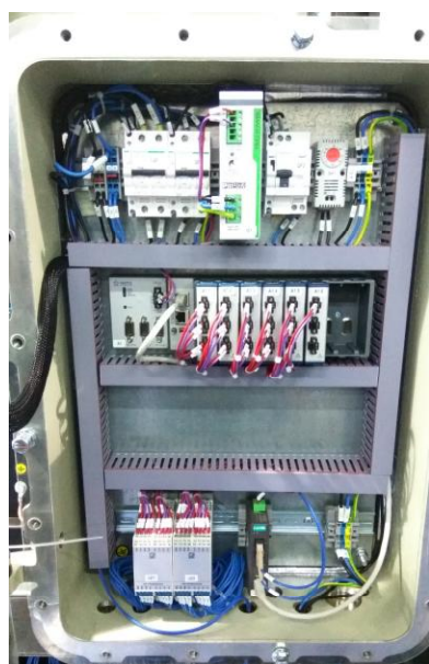
Рисунок 2 - Общий вид шкафа электротехнического со снятой дверцей
