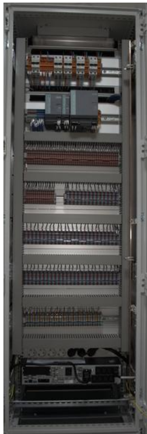
Рисунок 2 - Шкаф главного ПЛК (вид сзади)
