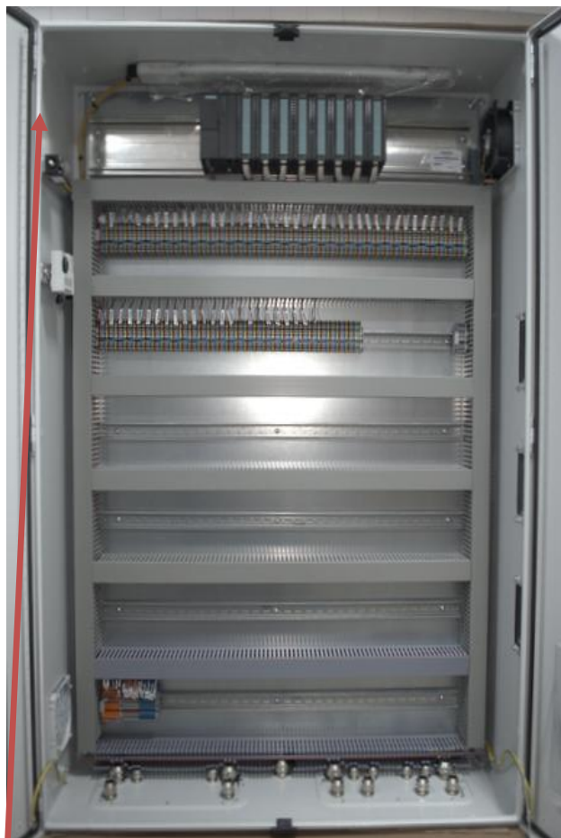
Рисунок 6 - Шкаф ПЛК станда 40 МВт (шкаф аналоговых сигналов)
