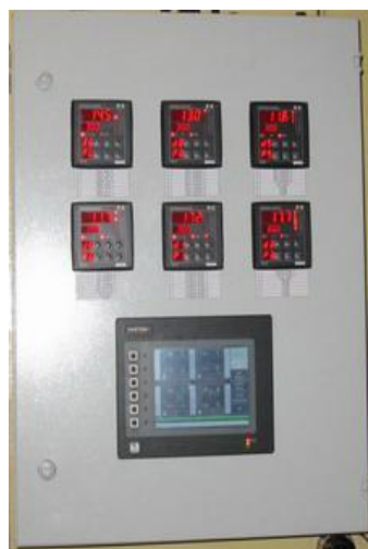
Рисунок 2 - общий вид шкафа-сборки
