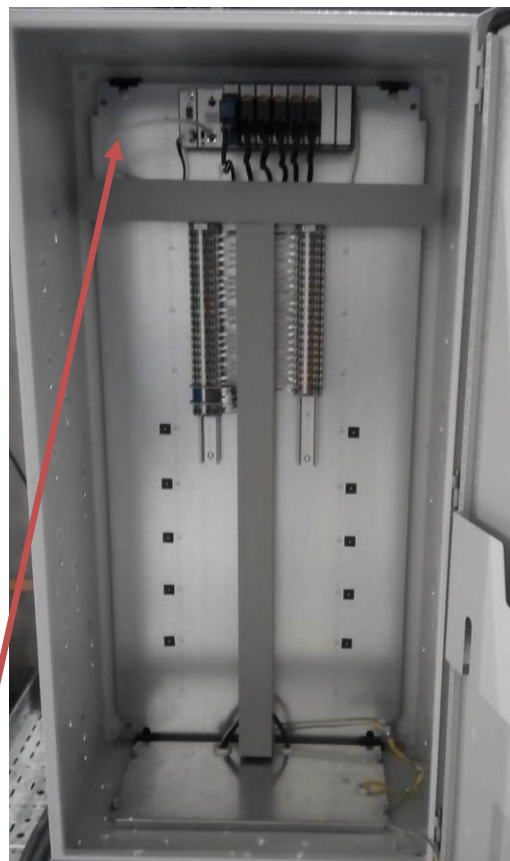
Рисунок 4 - Шкаф датчиков давления 2
