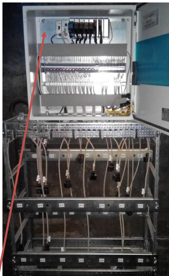
Рисунок 12 - Шкаф расходомерного коллектора 2
