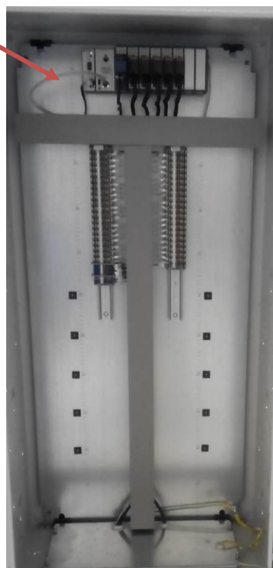
Рисунок 6 - Шкаф датчиков давления 4
