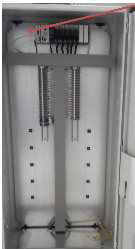
Рисунок 5 - Шкаф датчиков давления 3
