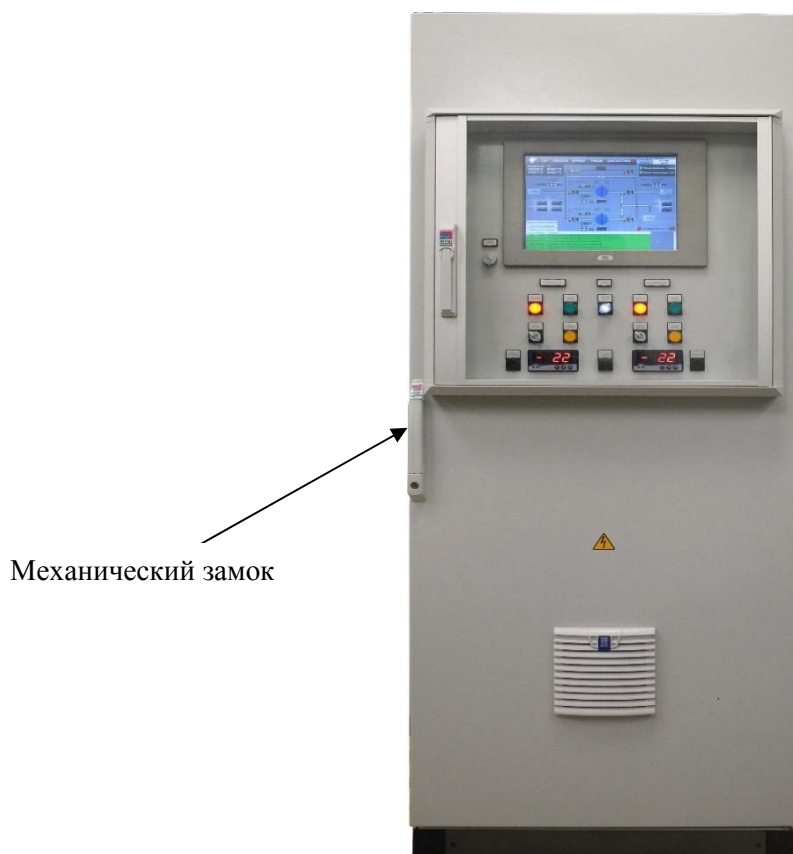
Рисунок 1 - Общий вид шкафа с ИК ПТК «РЕГУЛ»
