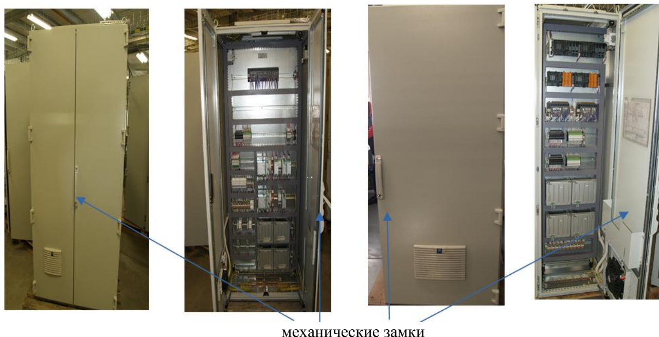
Рисунок 1 - Внешний вид шкафов комплекса
