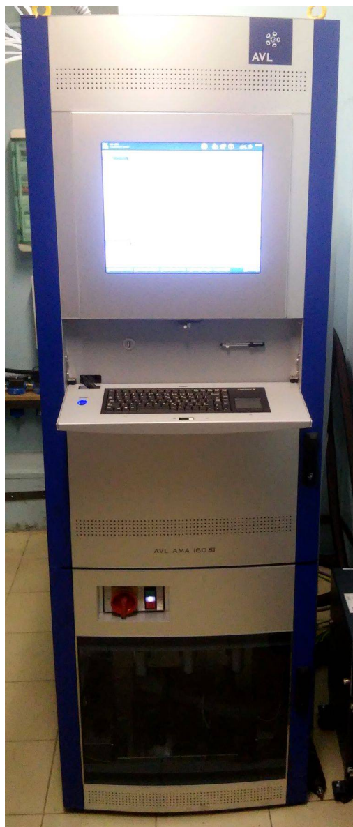
Рисунок 1 - Внешний вид шкафа с элементами системы
