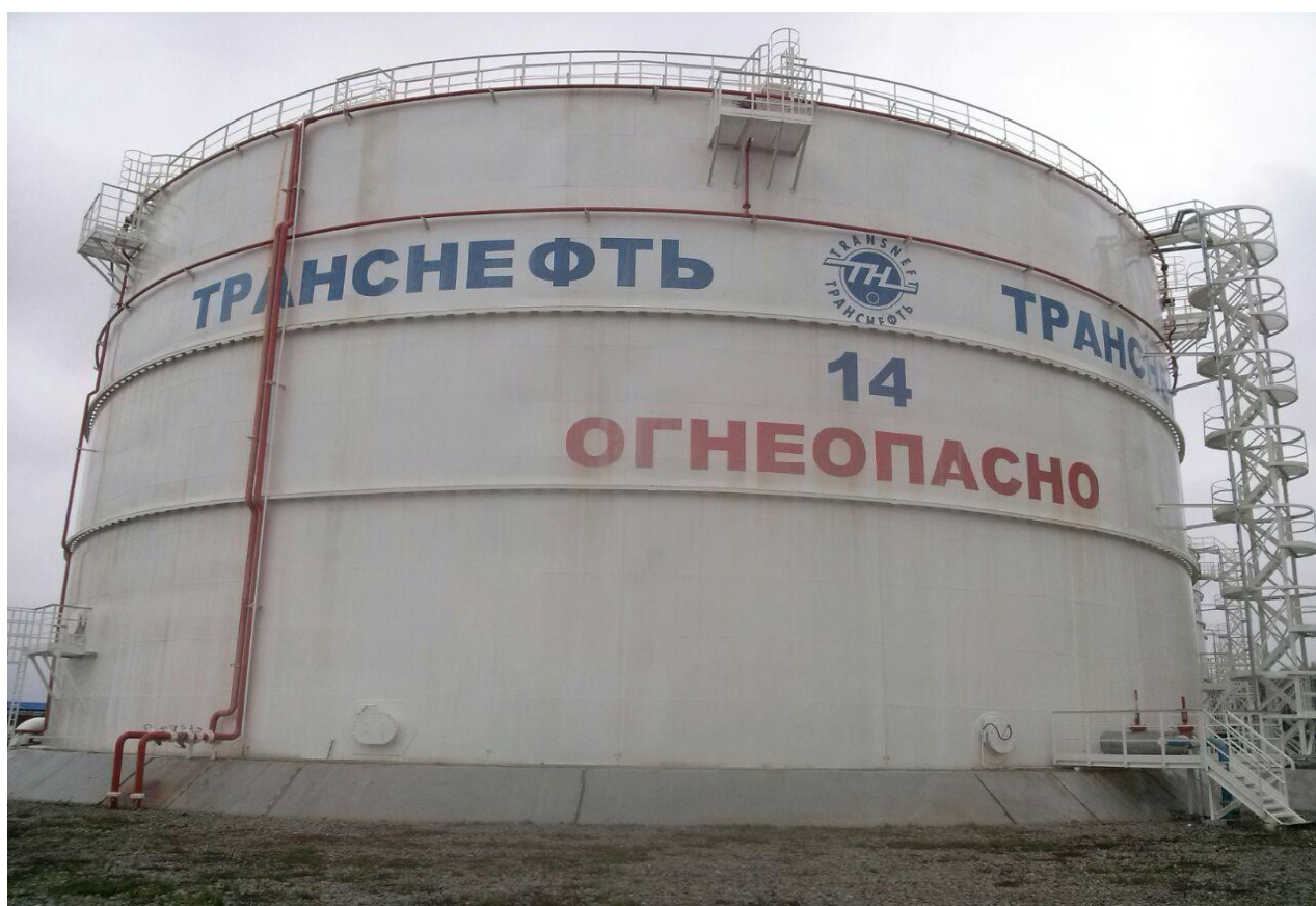
Рисунок 9 - Общий вид резервуара вертикального стального цилиндрического RVSP-20000
