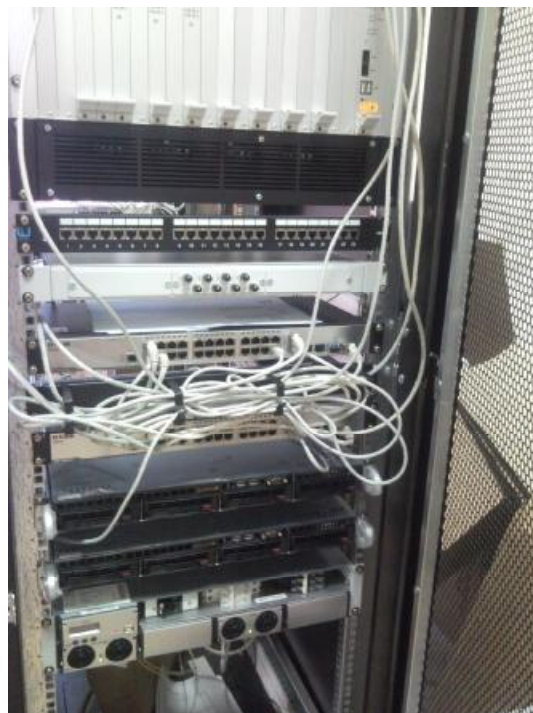
Рисунок 2 - Общий вид оборудования с открытой дверью
