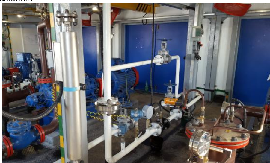
Рисунок 1 – Общий вид СИКН
