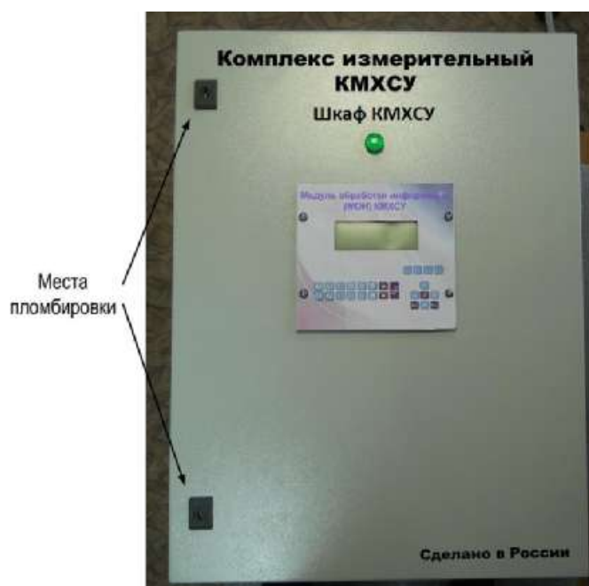
Рисунок 2 - Места пломбировки шкафа комплексов
