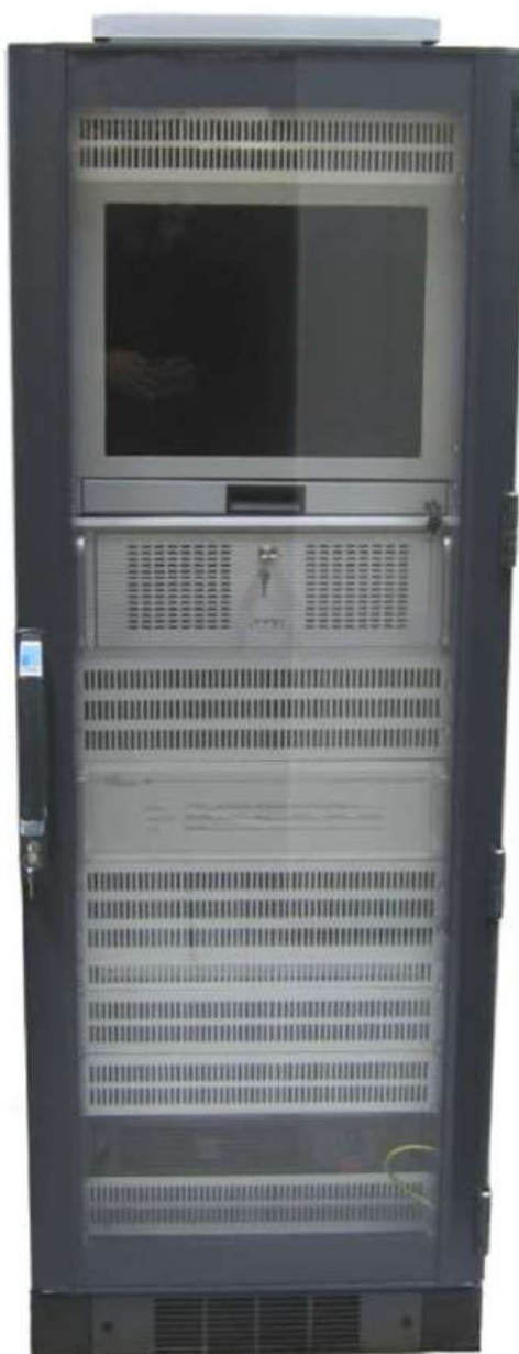
Рисунок 1 - Внешний вид телекоммуникационного шкафа системы мониторинга температуры кабельных линий СМТКЛ
