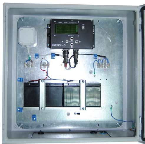
Рисунок 2 - Устьевого приемный бокс УПБ с блоком ВИЗИР-5
