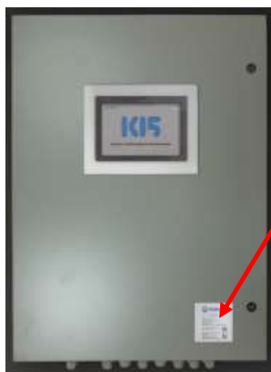
Рисунок 1 – Контроллер в шкафу общепромышленного исполнения
