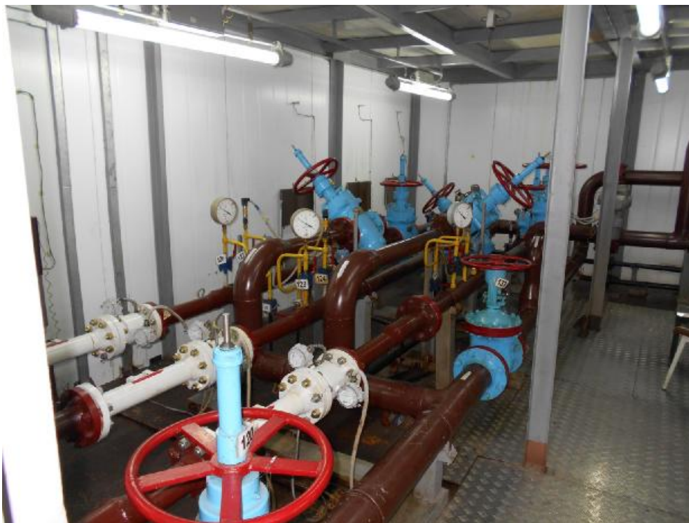
Рисунок 1 – Общий вид СИКН
