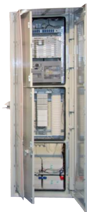
Рисунок 1 - Общий вид оборудования с открытой дверью шкафа
