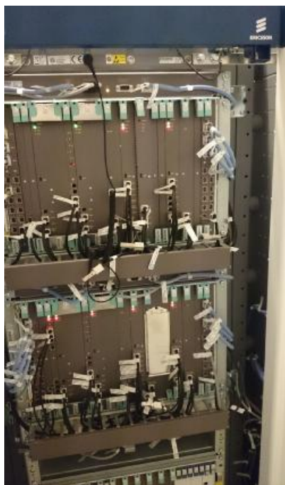
Рисунок 1 - Общий вид оборудования с открытой дверью
