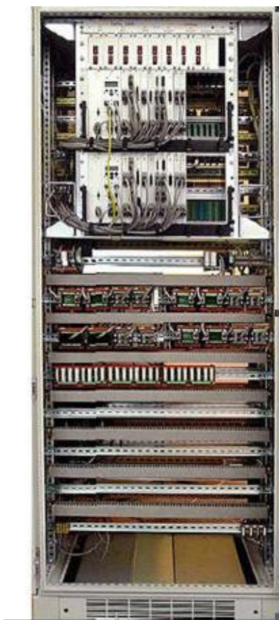
Рисунок 1 – Общий вид контроллера Р-380 в аппаратном шкафу.
