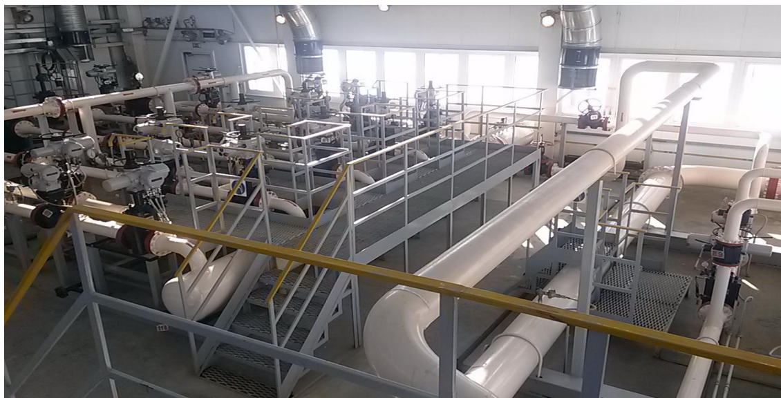
Рисунок 1 – Общий вид СИКН
