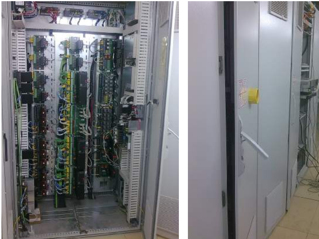
Рисунок 1. Фото общего вида шкафов комплекса
