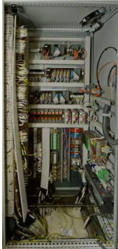
Рисунок 1 – Шкаф ИС САУ ДГУ
