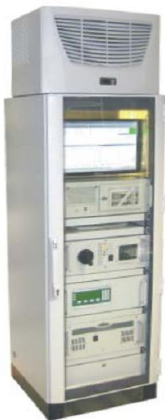
Рис.2. Внешний вид шкафа с приборной стойкой и приборами системы Gaset CEMS II (стационарное исполнение)
