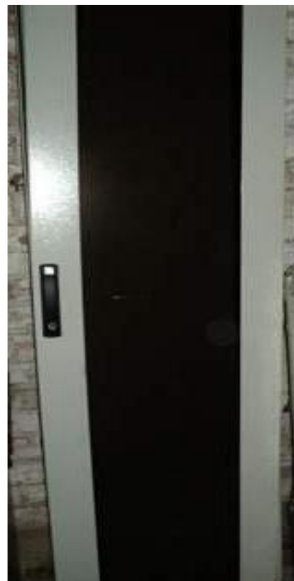
Рисунок 2 Оборудование в стойке с закрытой дверью и замком от несанкционированного доступа
