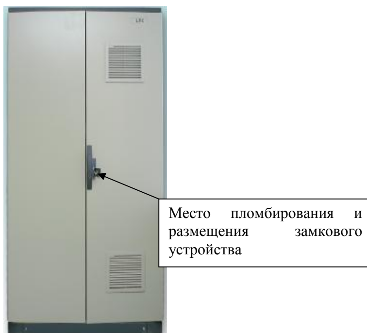
Рис. 1 - Внешний вид приборного шкафа
