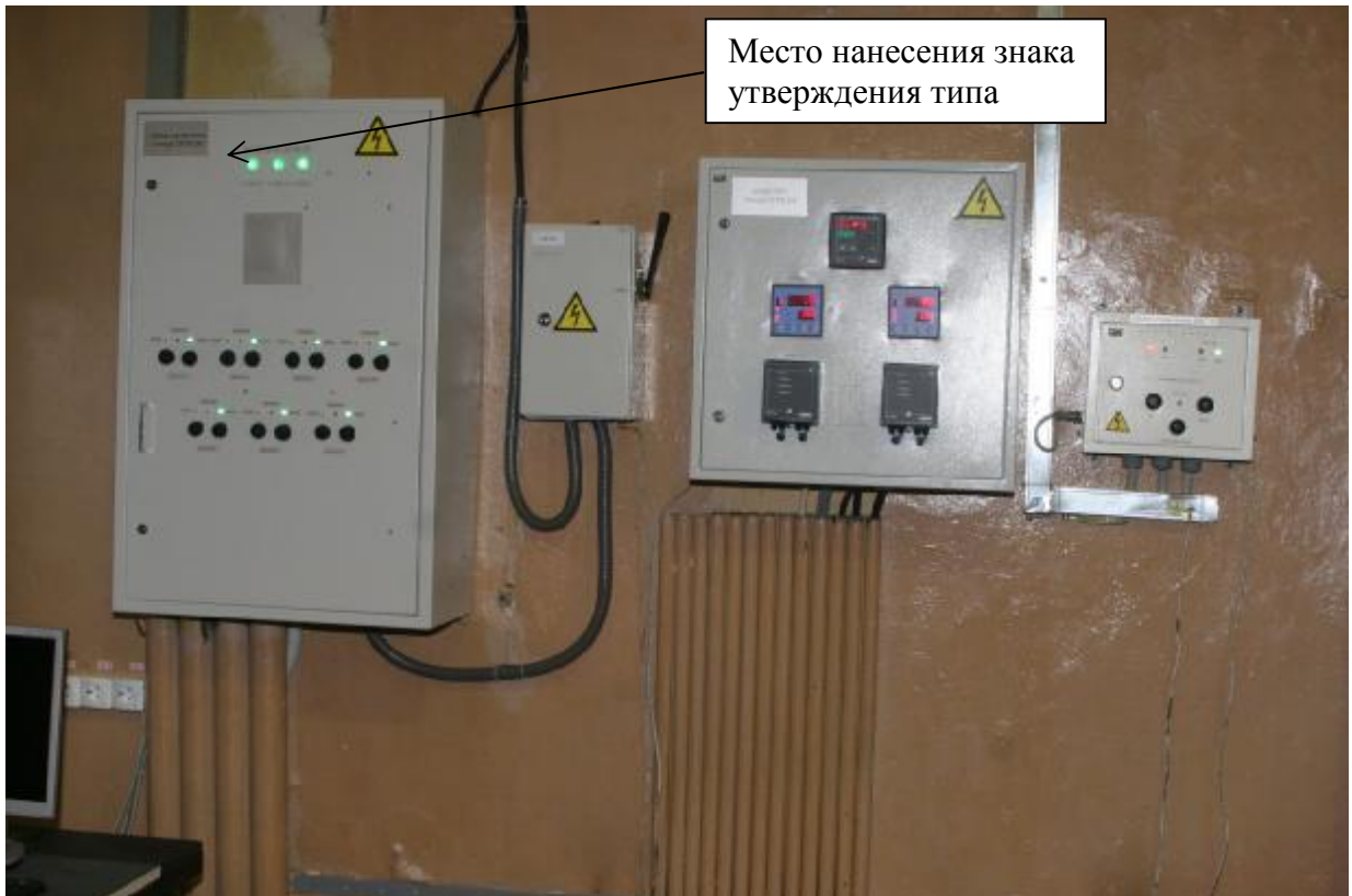
Рисунок 3 - Шкаф управления стендом, шкаф КИП, шкаф управления импульсным нейтронным генератором
