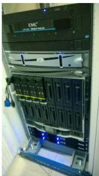
Рисунок 1 - Общий вид оборудования с открытой дверью
