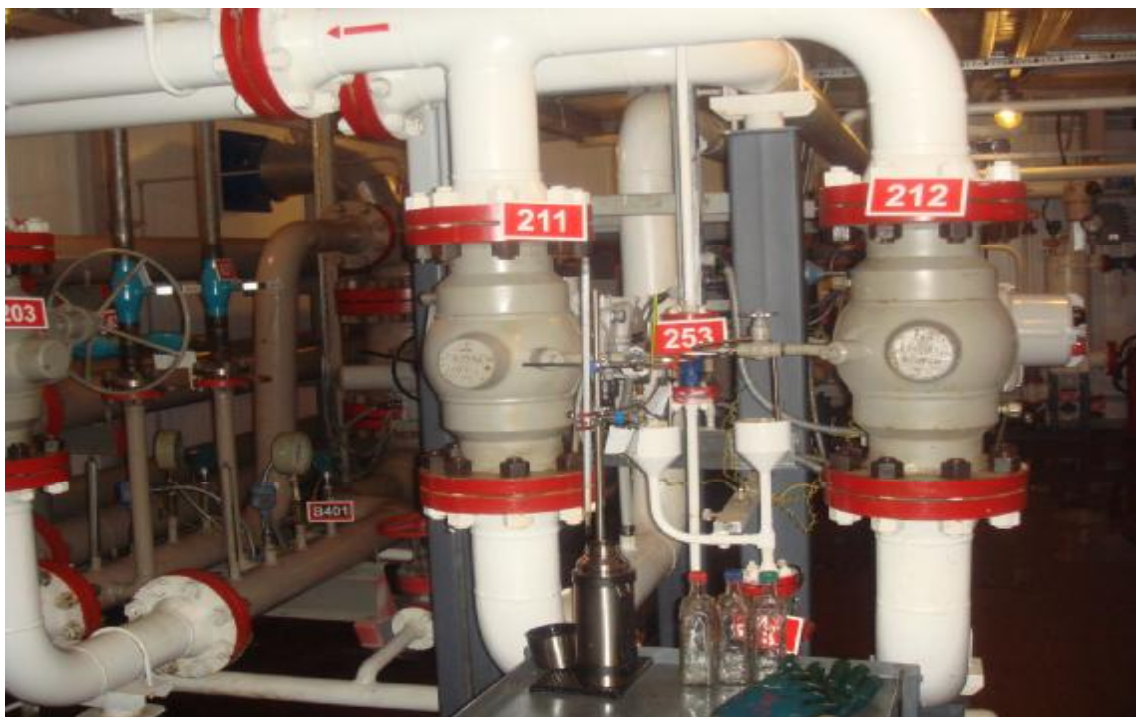
Рисунок 1 – Общий вид СИКН № 546
