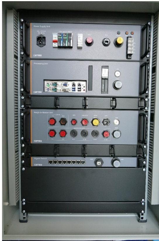
Рисунок 3 - Шкаф управления системы UnicamWIM с блоком обработки сигналов UC-WLU (пример)
