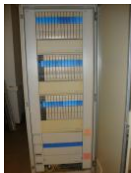
Шкаф с модулями ввода/вывода
