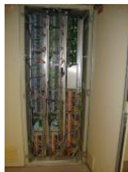
Шкаф с промежуточными преобразователями
