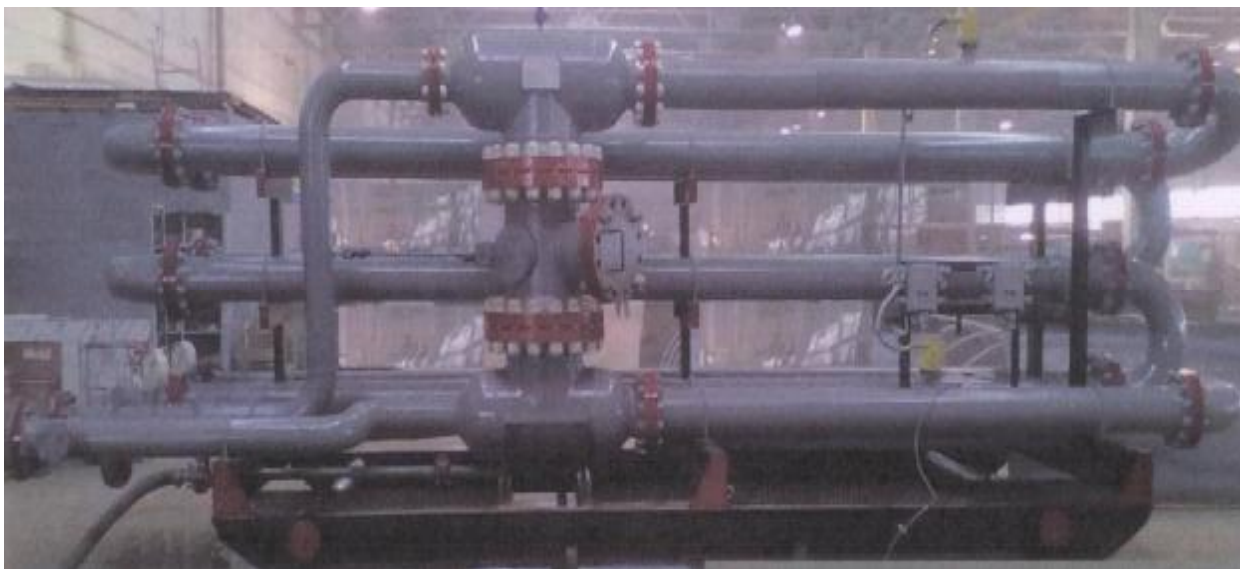
Рисунок 1 - Общий вид установок трубопоршневых
