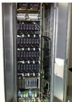
Шкаф с модулями ввода/вывода
