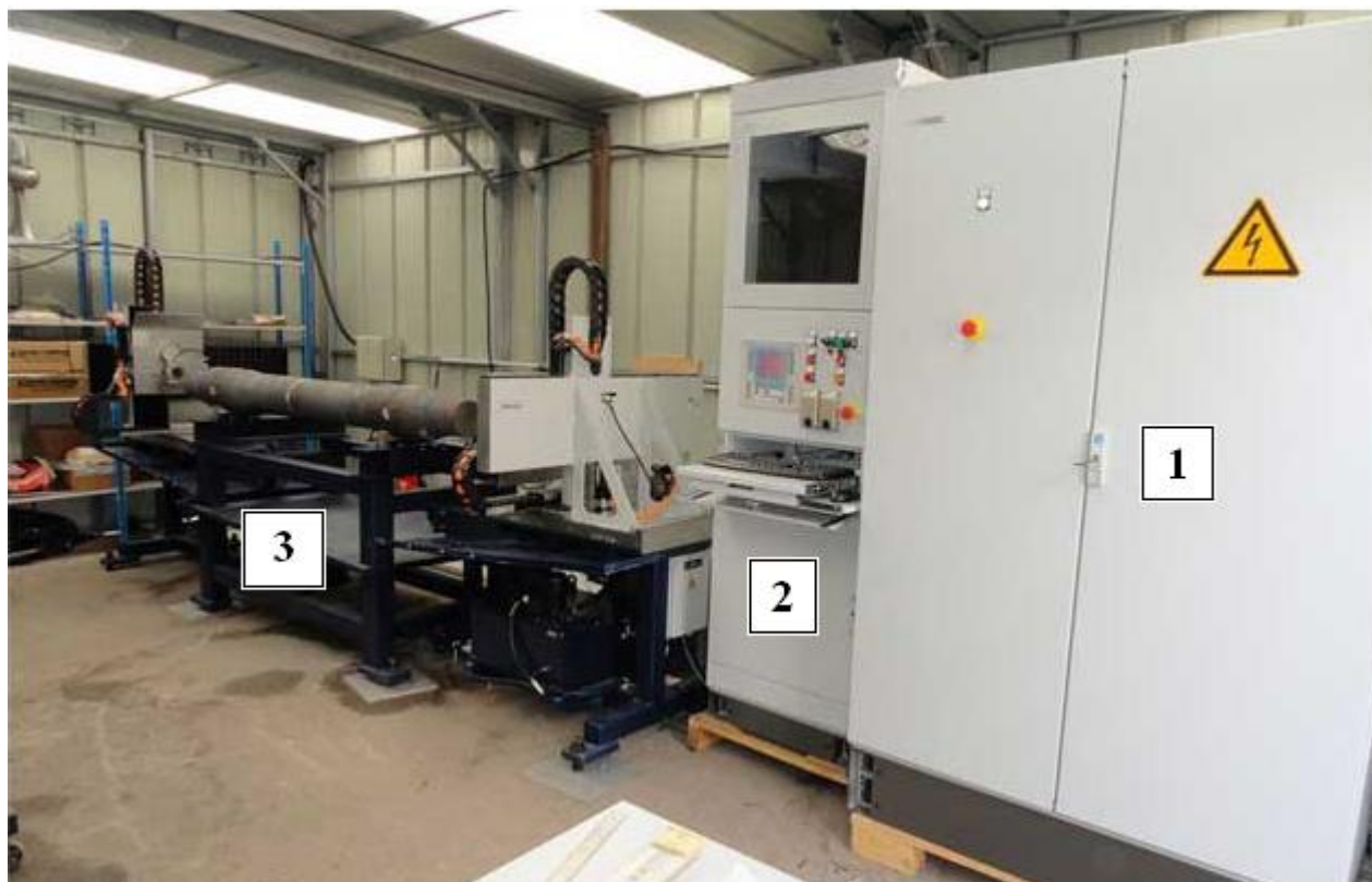
Рисунок 1 – Общий вид комплекса. На рисунке 1 цифрами обозначены: 1 – электрический шкаф; 2 – компьютерный блок управления; 3 - подставка под оси
