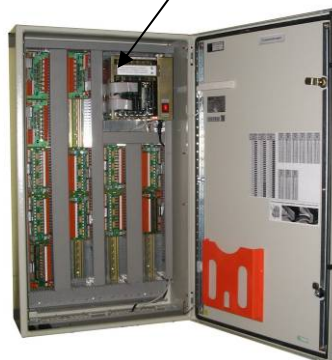
Рисунок 2 – Общий вид регистратора в составе шкафа навесного исполнения
