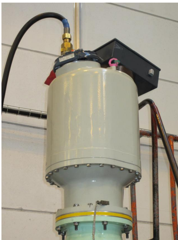
Внешний вид трансформатора напряжения UMP 145 и место пломбирования
