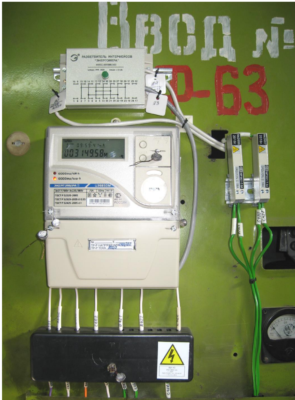
Расположение счётчика электрической энергии, разветвителя интерфейсов, переходной колодки и нагрузочных резисторов в одном из измерительных каналов (аналогично располагаются элементы и в других измерительных каналах)
