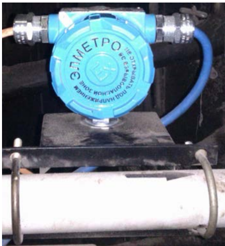
Измерительный модуль на кронштейне
