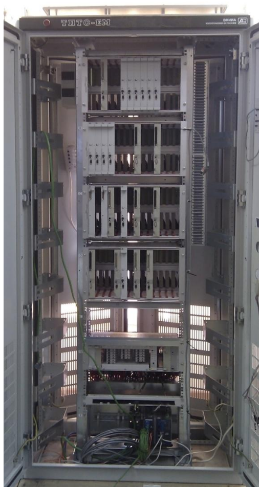
Рисунок 1 - Шкаф с установленными модулями
