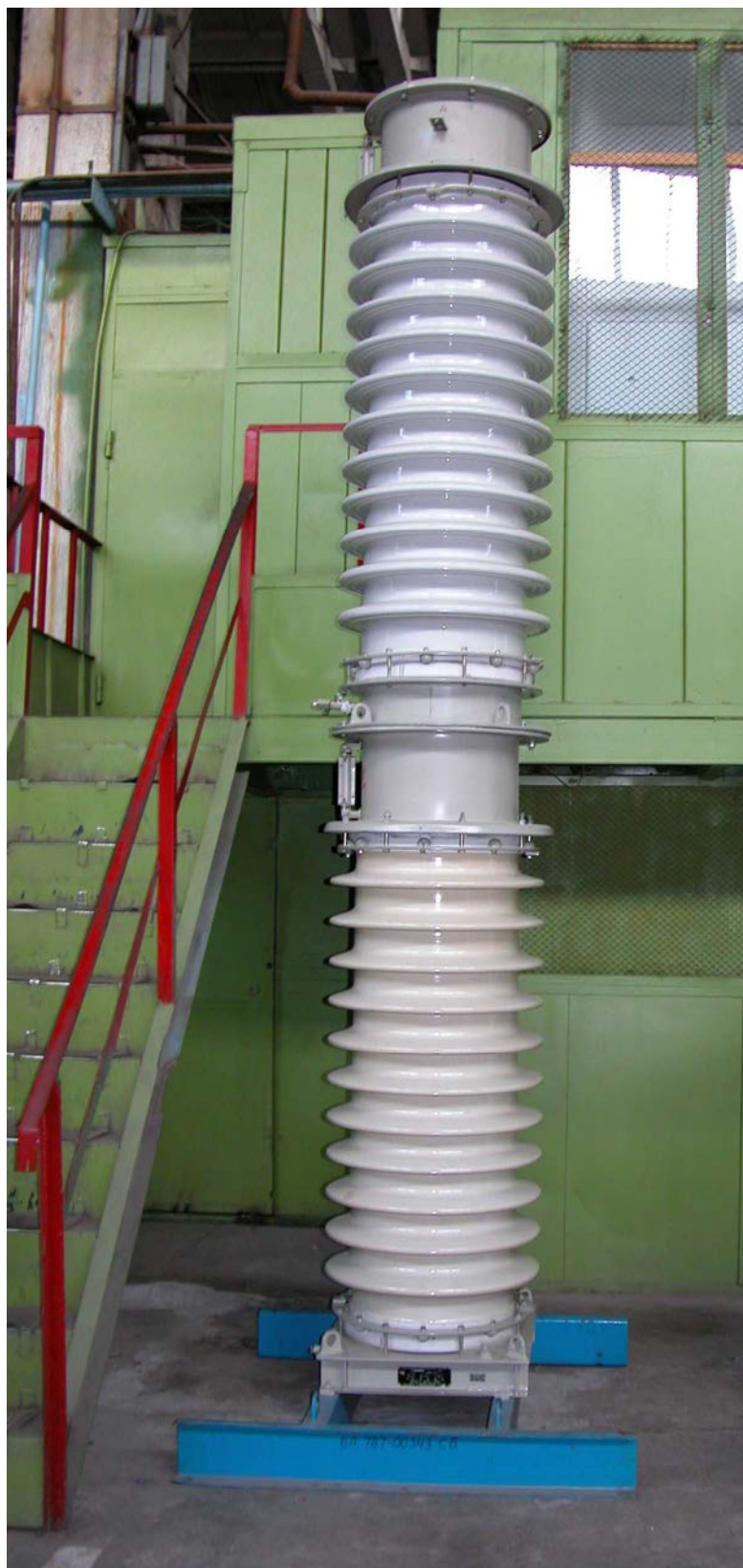
Рис.2 Трансформатор напряжения НКФА 220
