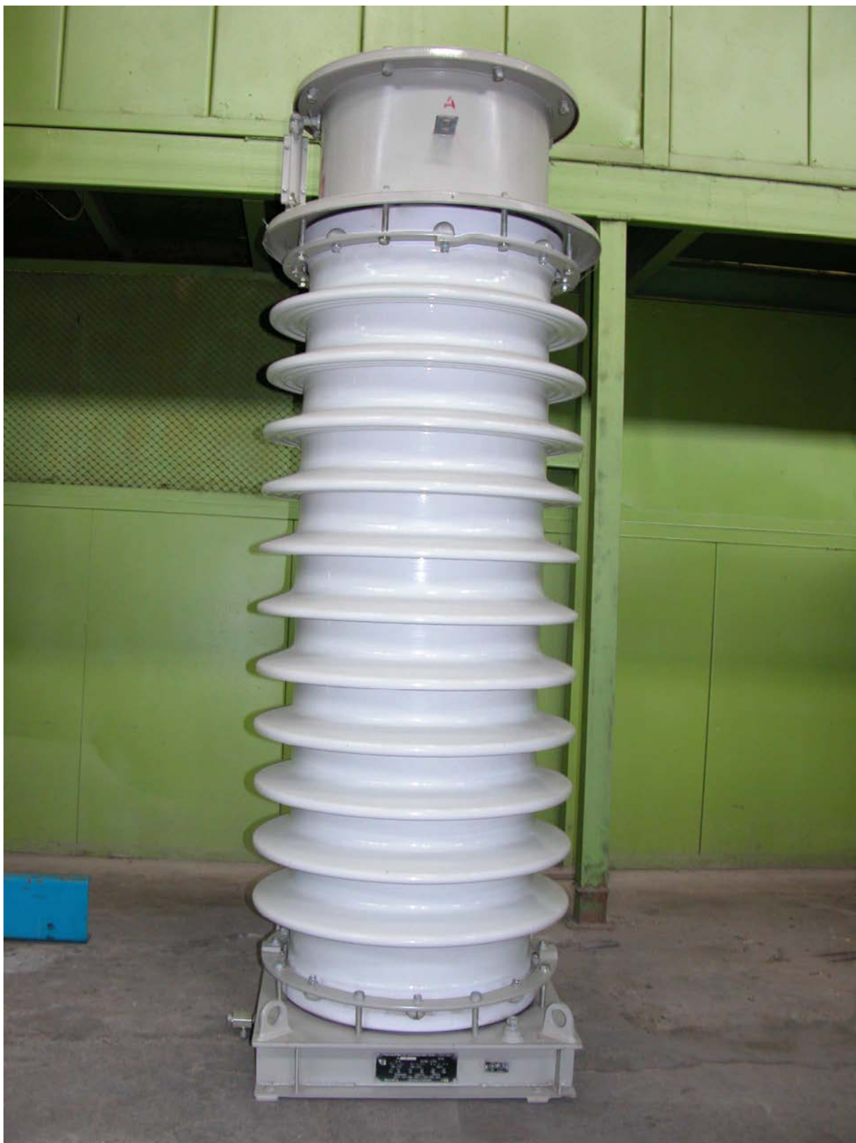
Рис.1 Трансформатор напряжения НКФА 110
