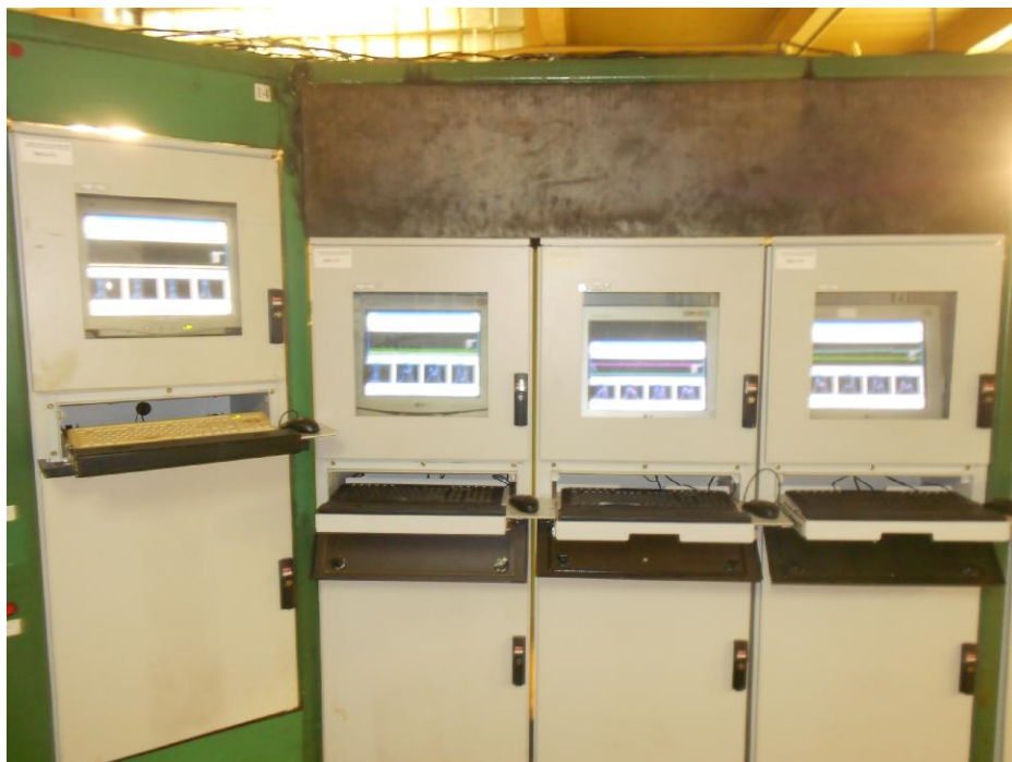
Рисунок 3 — Общий вид стоек анализаторов «4К» с персональными компьютерами
