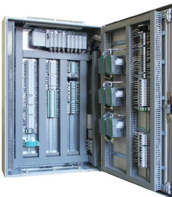
Рисунок 1 - Общий вид ПТС САУ «Комплекс»
