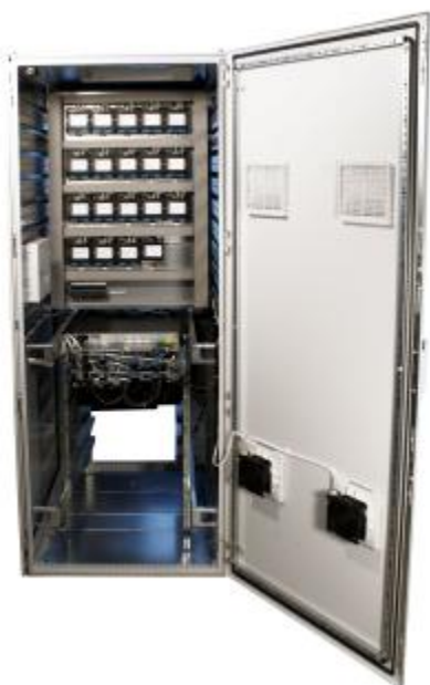
Рисунок 2 – Общий вид шкафа центральной сигнализации (2000×600×600 мм, двустороннего обслуживания) (пример)
